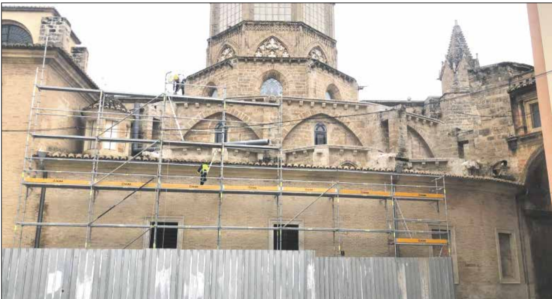
Imágenes del exterior de la Catedral de Valencia, con la colocación de andamios.
