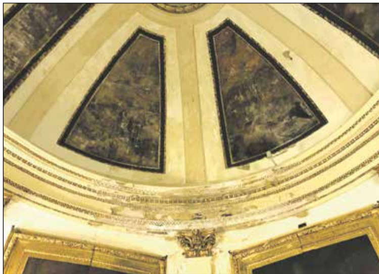
Deterioro por las filtraciones de las pinturas y las decoraciones de las arquitecturas del interior de la Capilla del Relicario.
